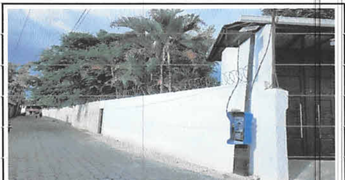
FOTO 4: ENSABIETADO EN TAPIAL DE MURO PERIMETRAL
